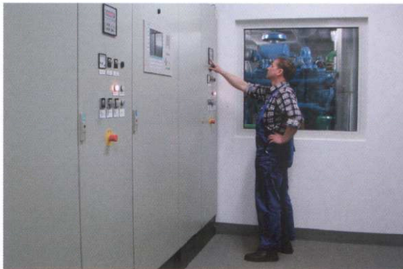
BHKW-Klärgasbetrieb Zwei-Modul-Anlage je 174 kWelekt./260 kWtherm. Schaltanlagenraum mit Blick in BHKW-Maschinenraum
