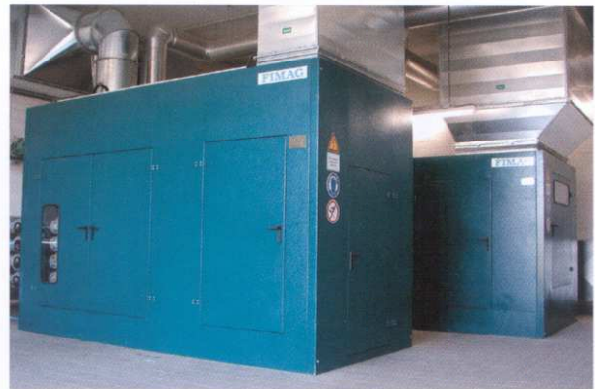
BHKW-Klärgasbetrieb 170 kWelekt./256 kWtherm. mit Notstromaggregat 500 kVA als Kompaktanlage
