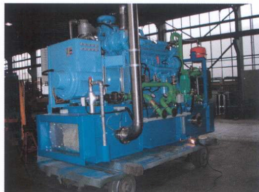
BHKW-Klärgasbetrieb 170 kWelekt./256 kWtherm.
