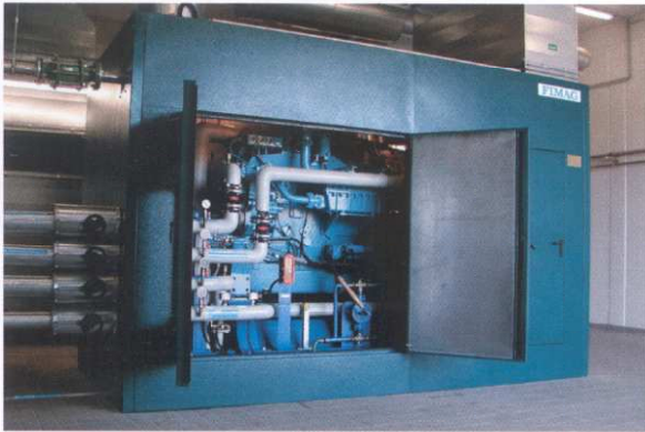
BHKW Dualgas (Erdgas/Klärgas) 170 kWelekt./256 kWtherm. - superschallgedämmt
