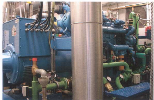
BHKW-Klärgasbetrieb Zwei-Modul-Anlage je 174 kWelekt./260 kWtherm. Schalldämmung des Maschinenraums
