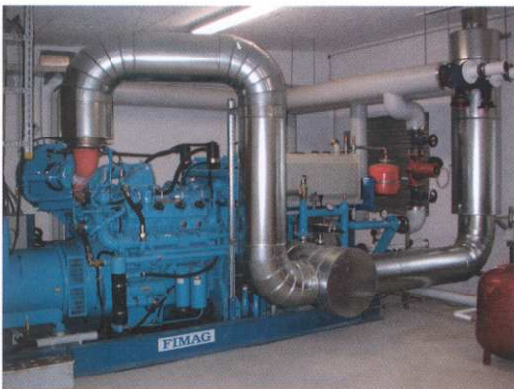
BHKW-Biogas 216 kWelekt./325 kWtherm. Modul im Maschinenraum einer Milchviehanlage
